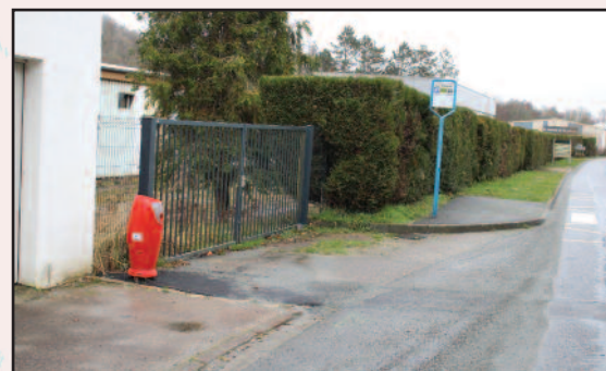
Borne incendie Rue René Coty
