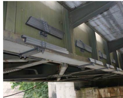
absorbeur sur platelage
