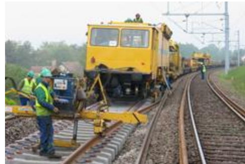
Longs Rails soudés sur traverses béton
